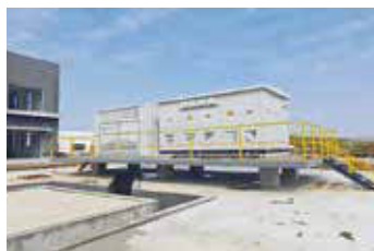
内蒙古鄂尔多斯某能源集团一期储能项目
