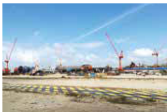
中东某地区建筑工地拖挂式临时电源解决方案
