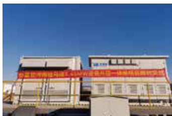
河南驻马店某能源集团一期储能项目
