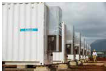
欧洲某能源集团节能测试规模应用
