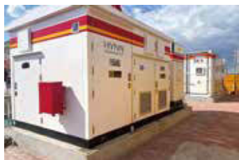
黑龙江大庆某综合国企储能项目
